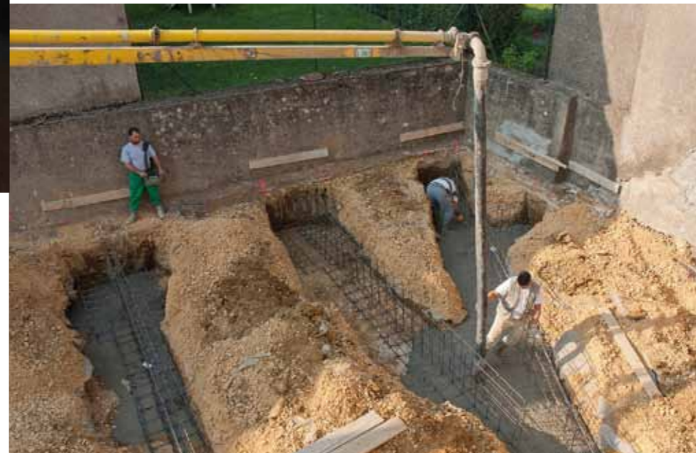
AVRIL 2011 : Les fondations sont coulées. Les murs existants n'ayant pas de fondations, il a été décidé d'en créer perpendiculairement à ceux-ci.
